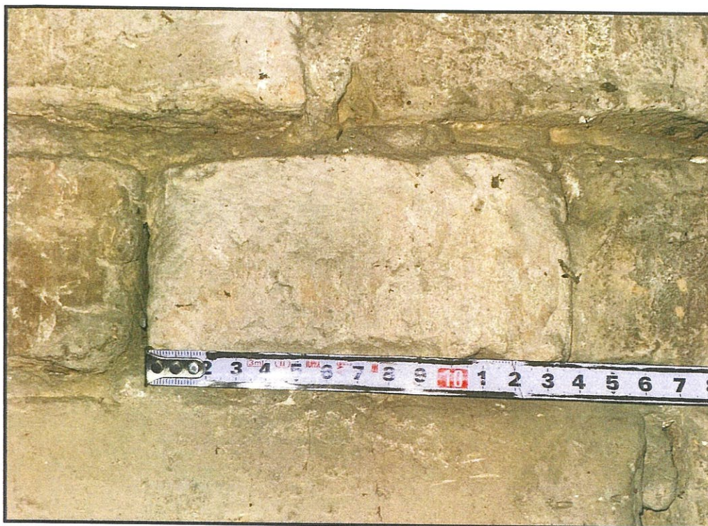
Fot. nr 17 Odkrywka muru ceglano. Wymiary cegły 13cm x 7cm.
