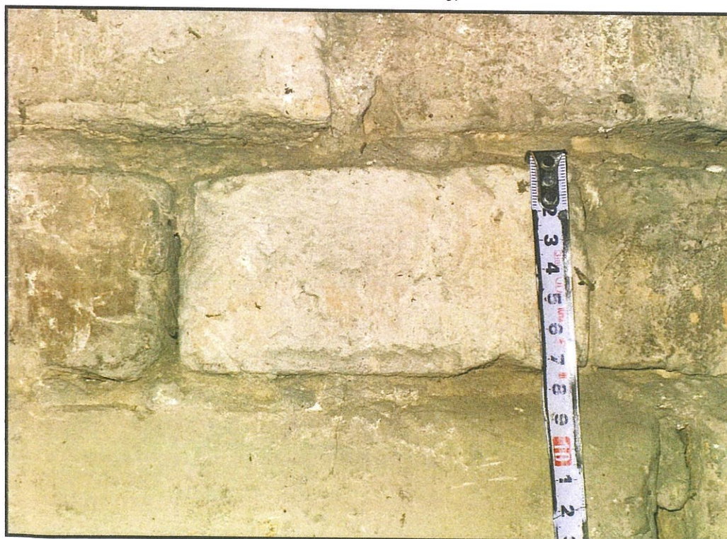
Fot. nr 18 Odkrywka muru ceglano. Wymiary cegły 13cm x 7cm.
