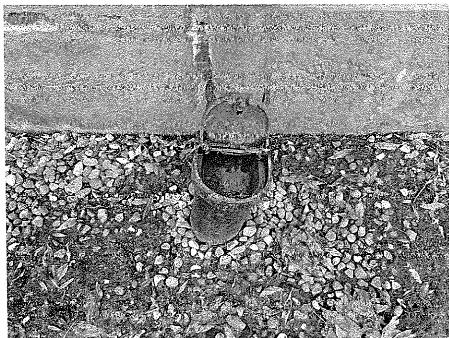
Fot. 14. Zapchana studzienka rewizyjna
