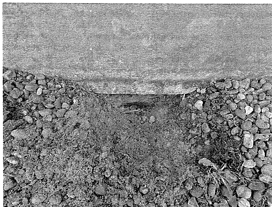
Fot. 16. Odkrywka B, brak widocznej izolacji pionowej
