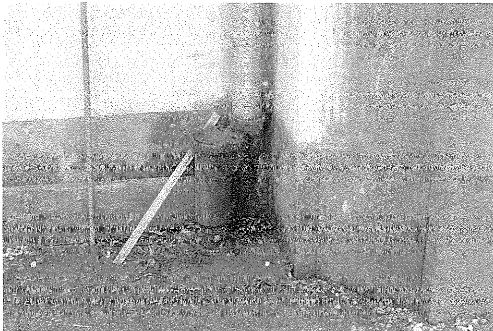
Fot. 7. Bardzo duża korozja biologiczna w postaci glonów i porostów, korozja chemiczna. Zapchany odpływ, woda wylewa się na zewnątrz, zawilgacając mur.
