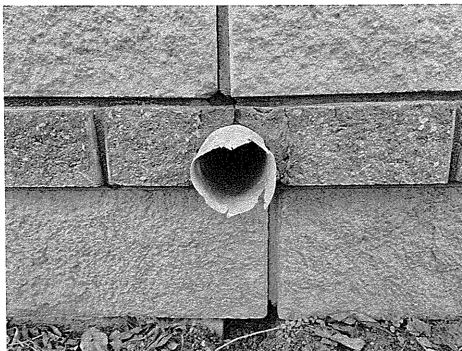
Fot. 13. Rura odpływowa o mniejszym przekroju niż rury spustowe. W rurze brak widocznych śladów przepływu wody w dni deszczowe.
