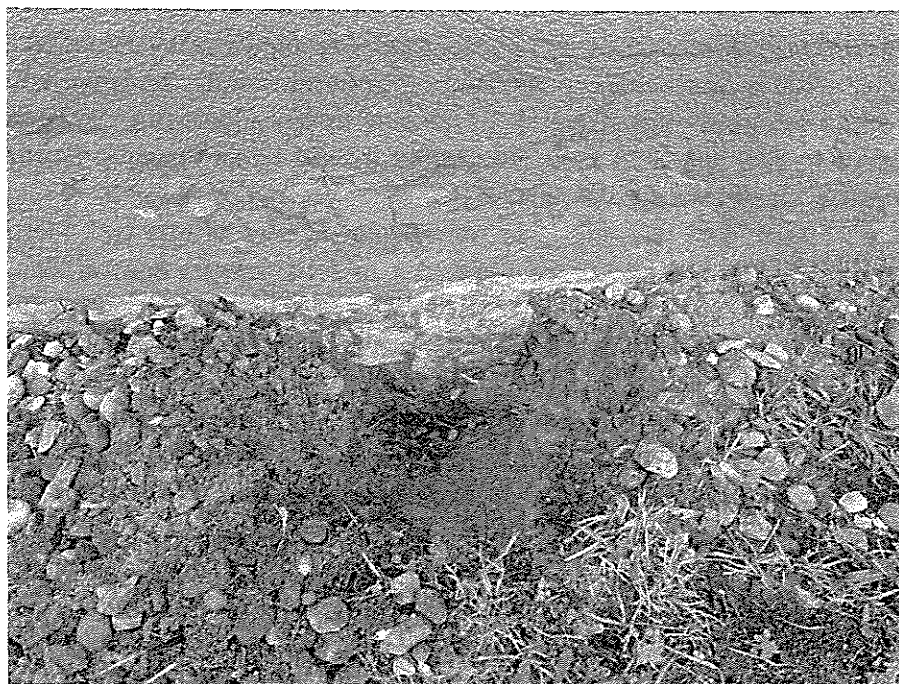
Fot. 15. Odkrywka A, brak widocznej izolacji pionowej
