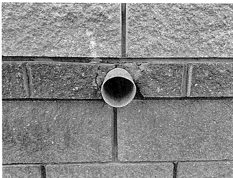
Fot. 12. Rura odpływowa o mniejszym przekroju niż rury spustowe. W rurze brak widocznych śladów przepływu wody w dni deszczowe.
