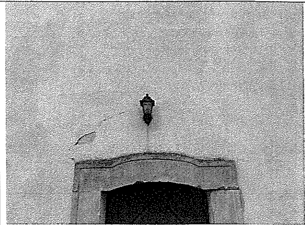
Zd.29 Widok uszkodzonego tynku nad portalem okiennym.
