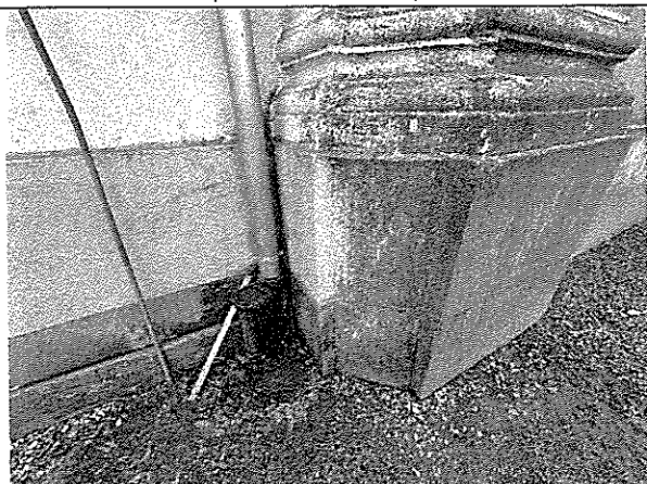
Zd.11 Widoczne zawilgocenie tynku przy rewizji rury spustowej
