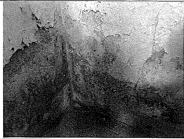
Zd.15 Zawilgocony tynk wewnętrzny
