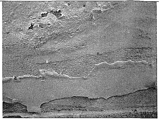
Zd.16 Zawilgocony tynk wewnętrzny
