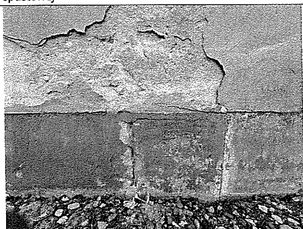
Zd.13 Widoczne zniszczenie cokołu kamiennego i tynku nad ciosami kamiennymi
