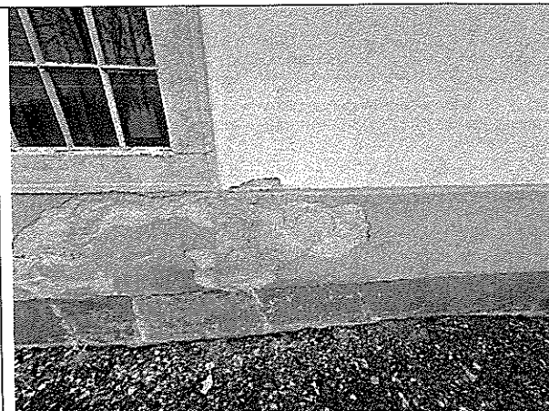
Zd.14 Widoczne zniszczenie cokołu pod oknem
