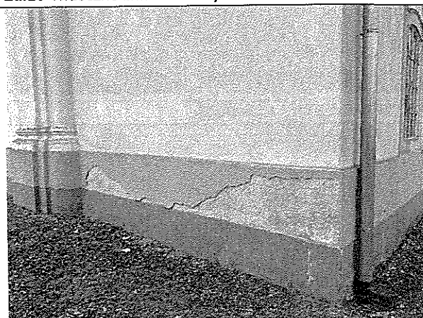
Zd.12 Zniszczony tynk w strefie cokołowej
