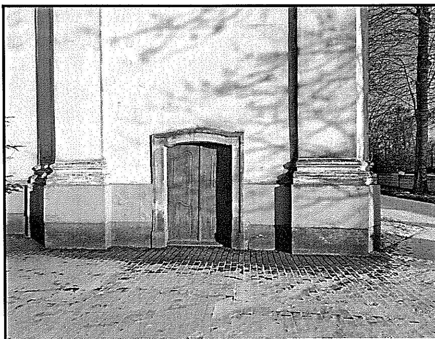
Fot. 22. Stan zachowania stolarki drzwiowej (zachodniej) kościoła w Regnowie.
