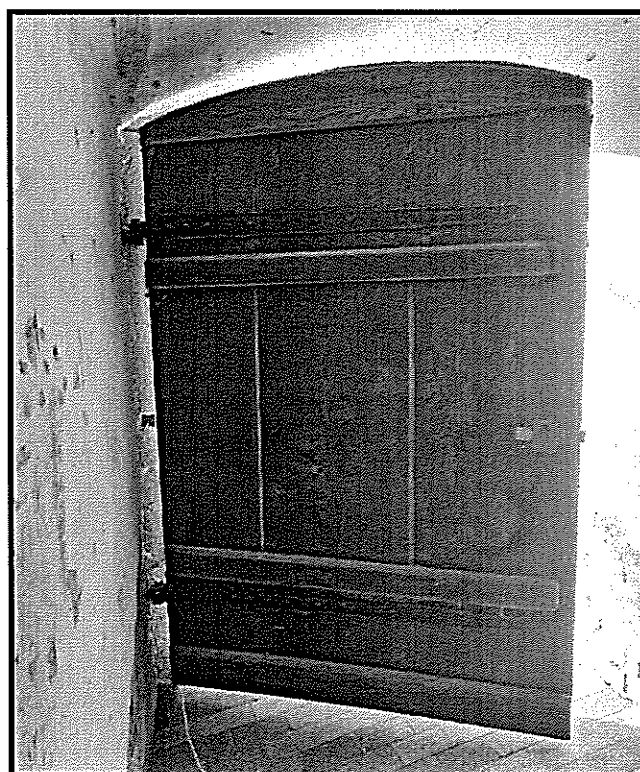
Fot. 28. Stan zachowania stolarki drzwiowej wykonanej z drewna dębowego. Brak oryginalnego zamka.
