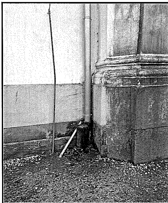
Fot. 36. Zły stan zachowania kamiennego cokołu wieży z silnym rozwojem mchów, porostów, glonów.
