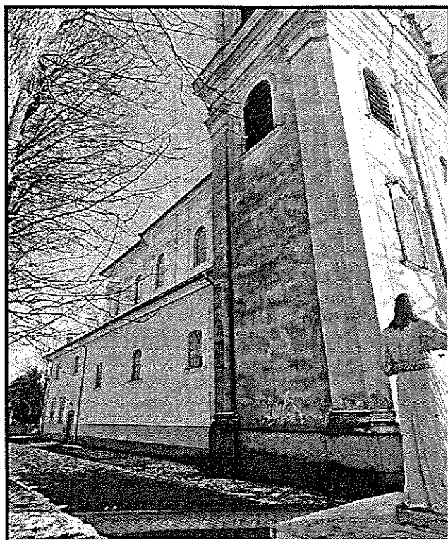
Fot. 35. Bardzo zły stan zachowania tynków i powłok malarskich wieży kościoła.
