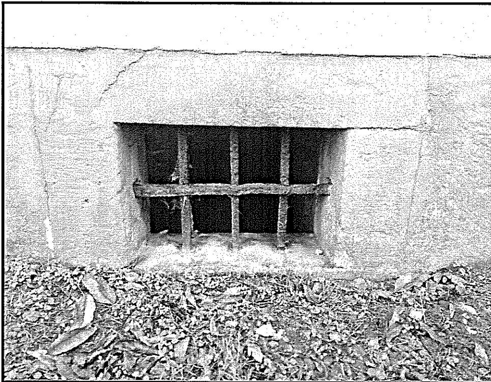
Fot. 55. Widoczne przemalowanie bloków piaskowca wraz z erozją kraty.
