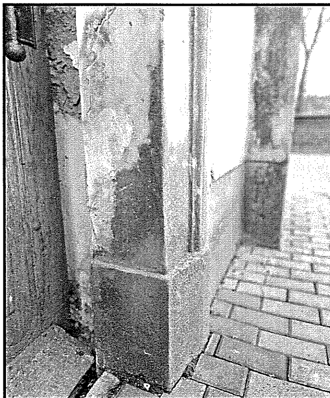
Fot. 27. Widoczny zły stan zachowania kamienia wraz z silnym rozwojem glonów, mchów porostów.
