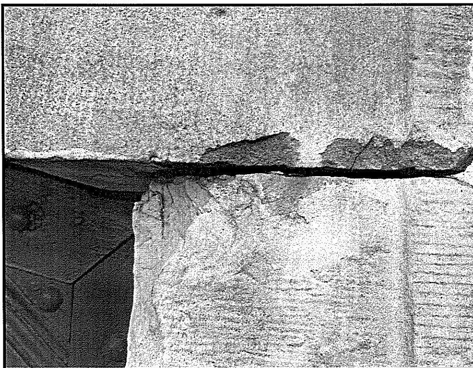
Fot. 42. Widoczne liczne uszkodzenia powierzchni kamienia.
