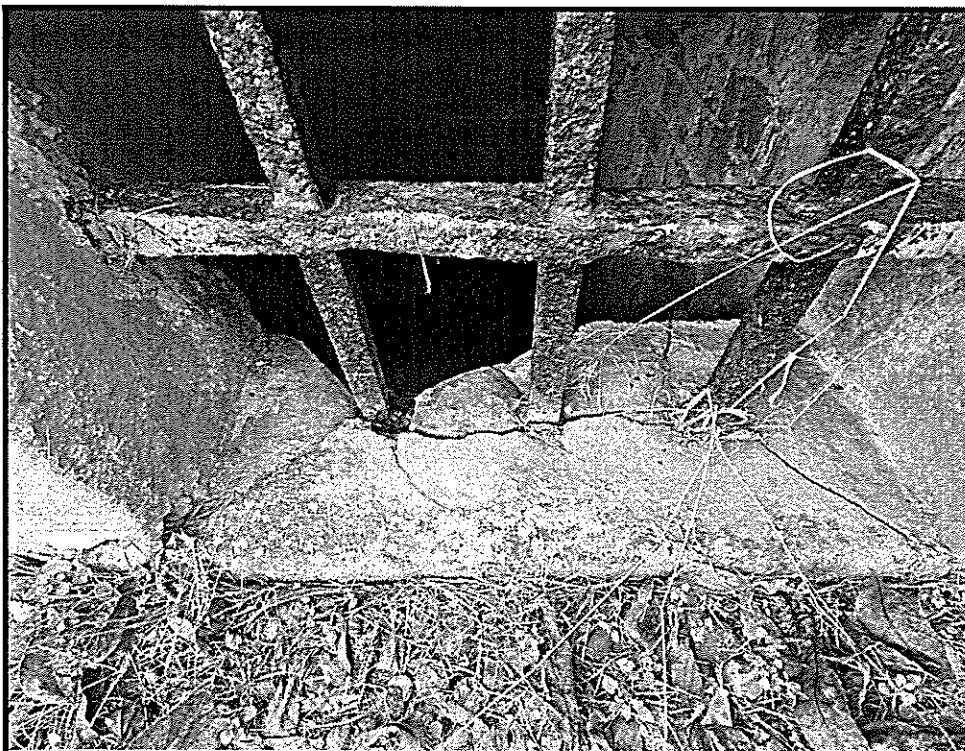
Fot. 56. Widoczny zły stan zachowania kamienia spowodowany korozją wżerową metalu.
