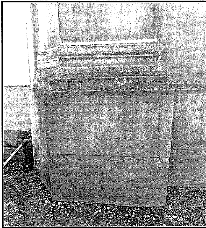
Fot. 37. Zły stan zachowania kamiennego cokołu wieży z silnym rozwojem mchów, porostów, glonów.
