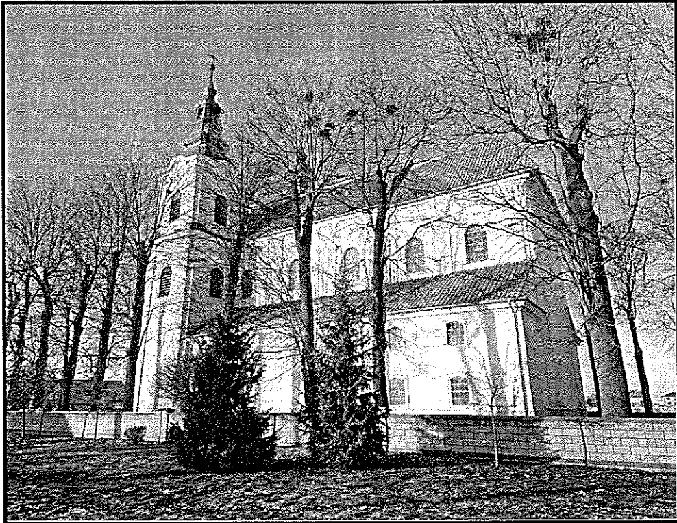
Fot. 57. Stan zachowania elewacji południowej kościoła w Regnowie.
