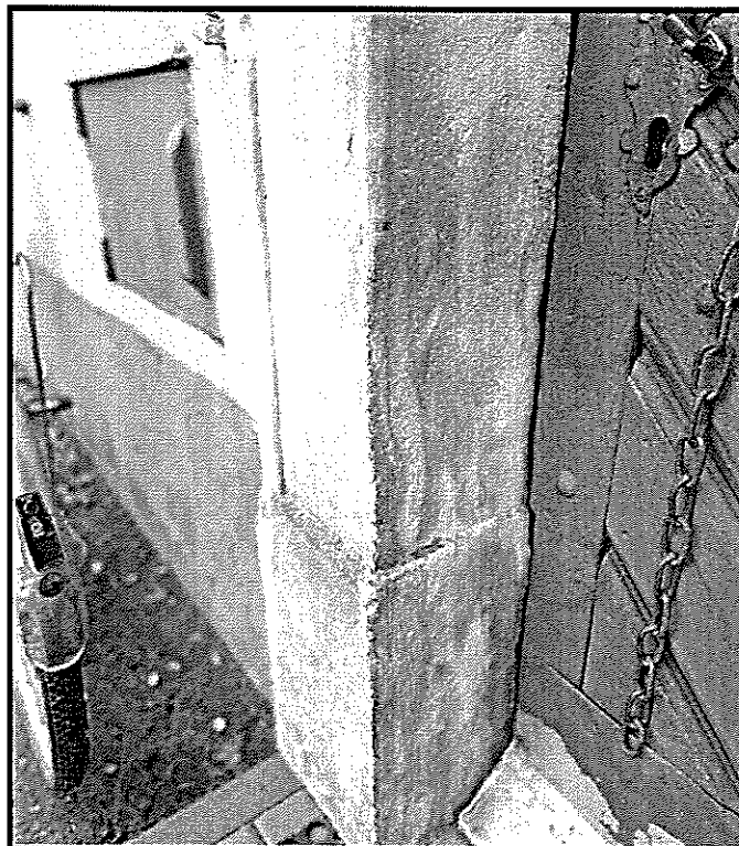
Fot. 44. Widoczne zasolenie powierzchni piaskowca.
