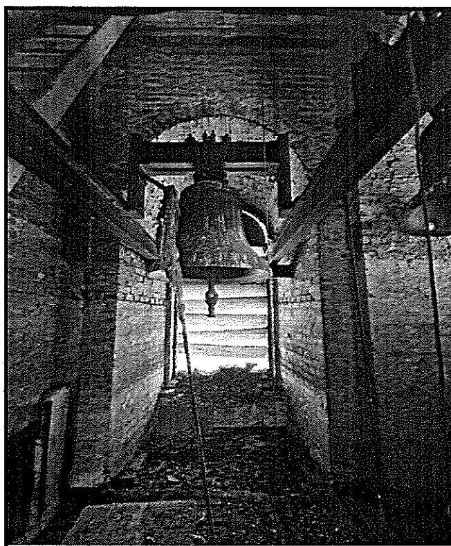
Fot. 63. Zanieczyszczenie guanem: zabytkowego dzwonu, wnętrza wieży.
