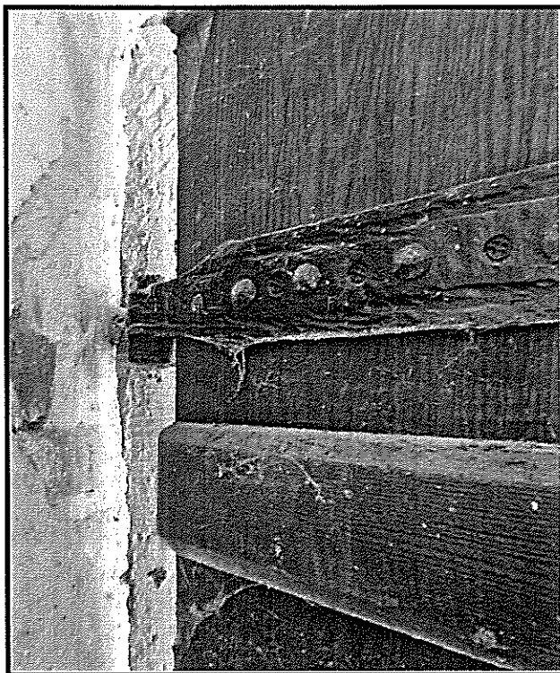
Fot. 29. Widoczny stan zachowania żeliwnych, kutyh elementów stolarki.
